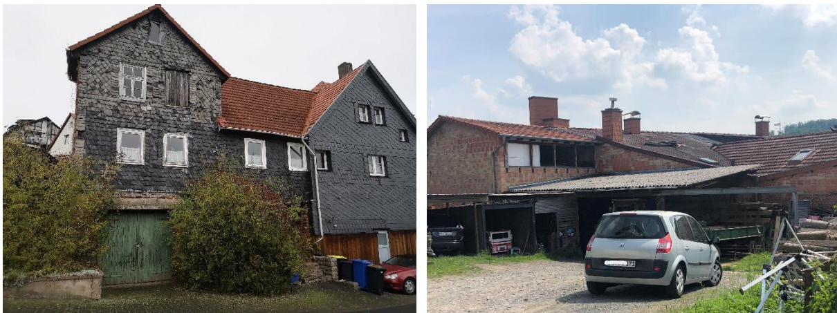
Abb. 32 Sanierungsbedarf an Gebäuden im Fördergebiet
